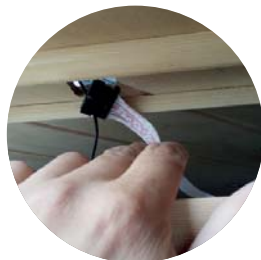
Ukázka protažení kabelů
